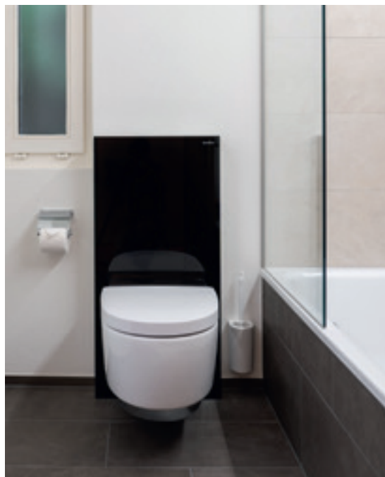
NACHHER Einbausituation mit Geberit Monolith
